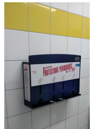
Un nouveau distributeur installé en 2024
