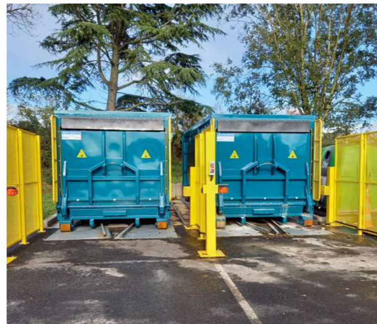
Compacteurs sur la déchèterie de Carquefou
